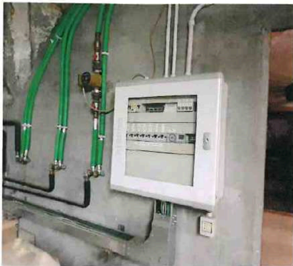
Quadro principale CT
